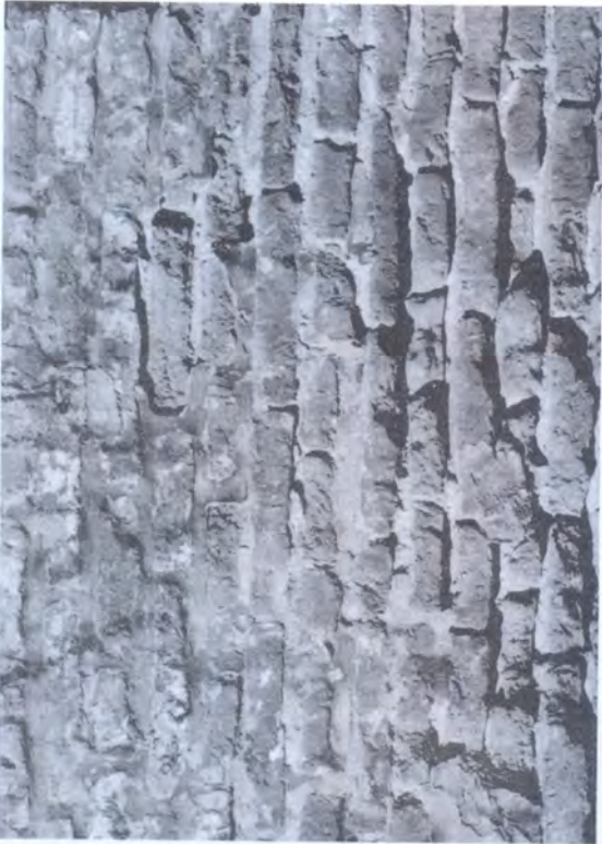
▲ Deterioros y faltantes de material en las juntas de los muros.
