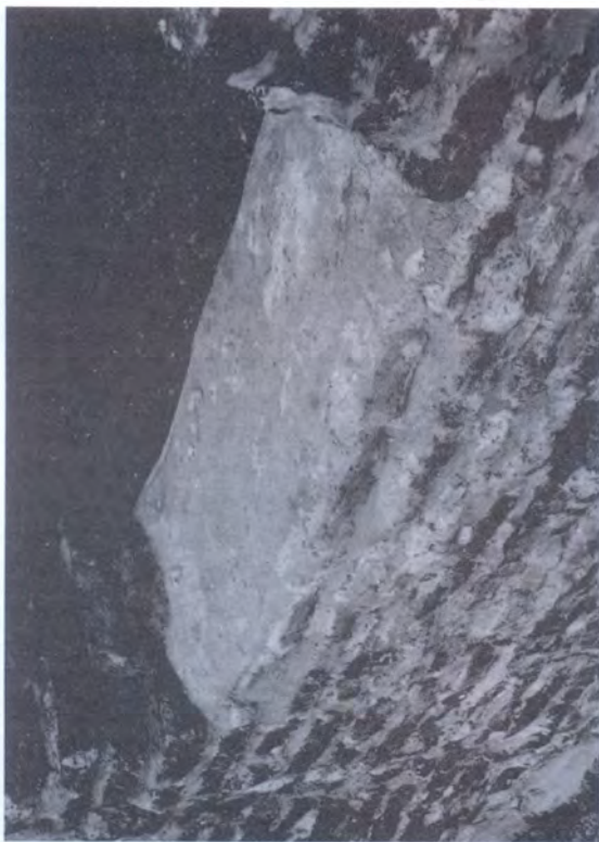
▲ Capa de drenaje en la parte inferior de un vano para su protección.
