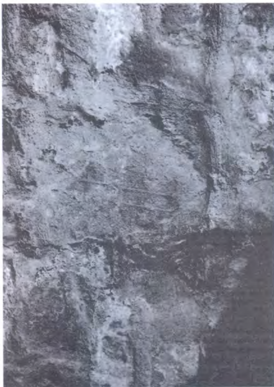
▲ Parches de cemento y arreglos precedentes hechos sin control y con materiales diferentes de los originales.
