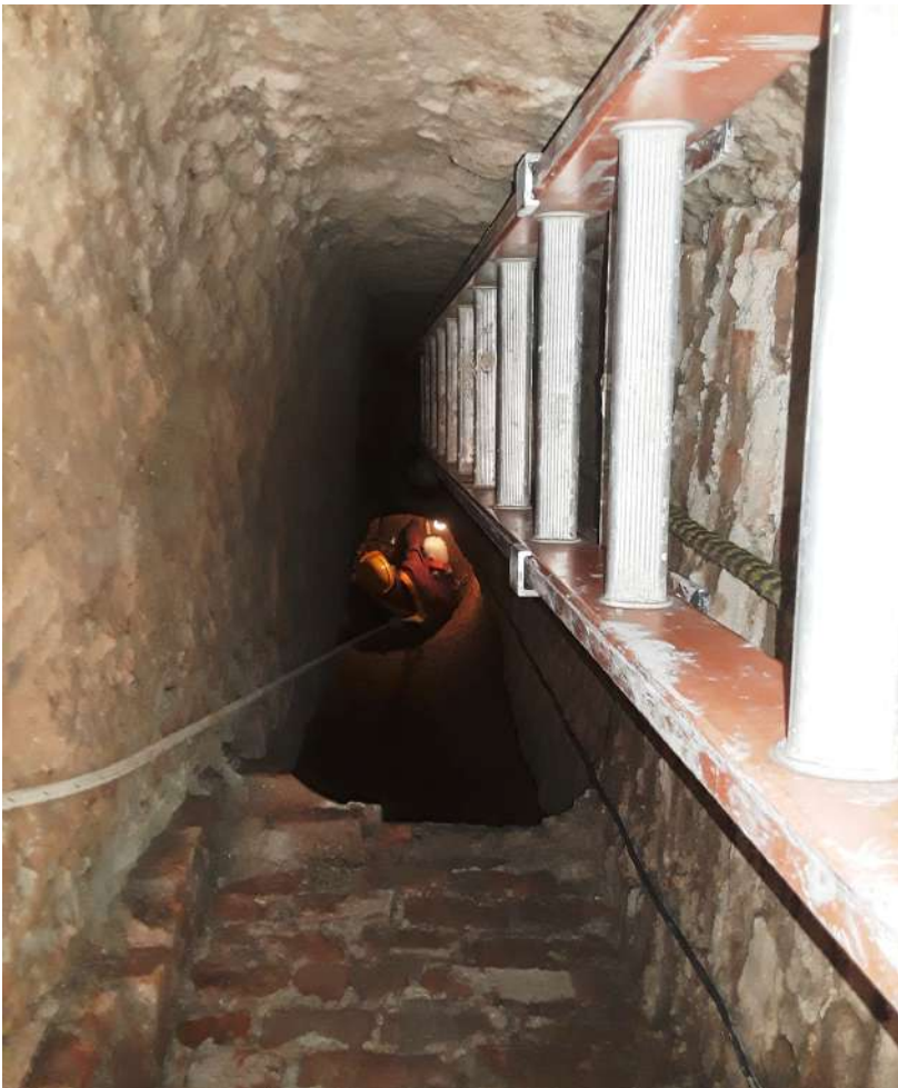
Vista del pozo rectangular, abajo se ve la unión con el pozo circular.
