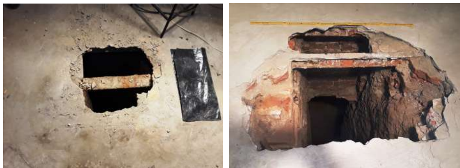
Estado del lugar al producirse el hundimiento y la primer apertura con el hallazgo de los pozos.
