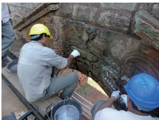
Figuras 10, 11 y 12. Portal de sacristía previo a limpieza y durante la misma. Tratamiento con productos químicos. Fuente: Documentación Obra Puesta en Valor 2009-2010
